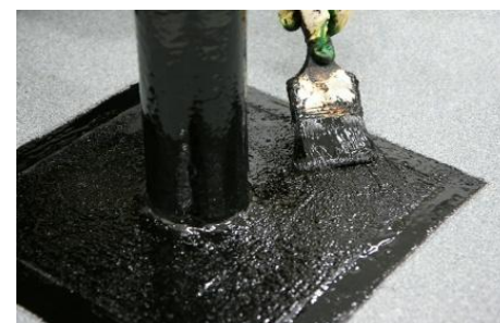
Рис. 23. Нанесение второго слоя мастики с запечатыванием кромок геотекстиля на горизонте в соответствии со схемой рис.7.
